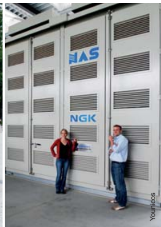
Cette batterie de stockage au sodium-soufre (NaS), construite par la firme japonaise NGK, fait partie des nouvelles technologies permettant d'assurer la continuité de la fourniture d'électricité. L'objectif de la société allemande Yunicos (50 personnes, Berlin), qui a effectué cet investissement, est de rendre des sites autonomes, à partir de sources d'énergie renouvelables. Elle a donc commencé par faire la démonstration chez elle de ce qu'elle préconise.
